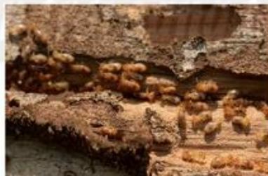
Mối phá hoại công trình xây dựng
