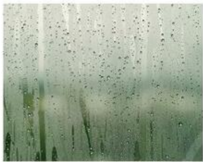
▲ Hình 8.12. Nước đọng trên kính trong nhà tắm
