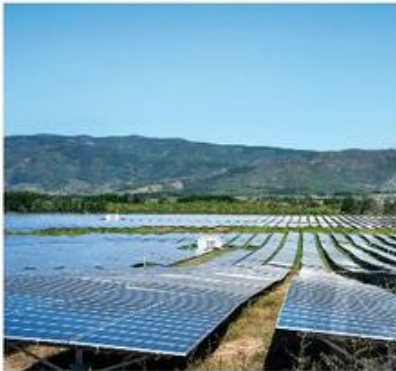
a) Trạm phát điện mặt trời (Khánh Hoà)
